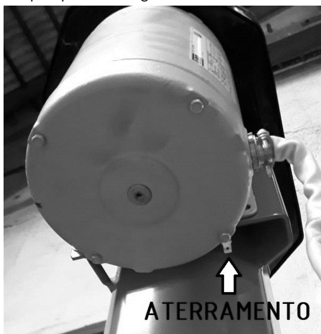
Ponto de aterramento do motor
