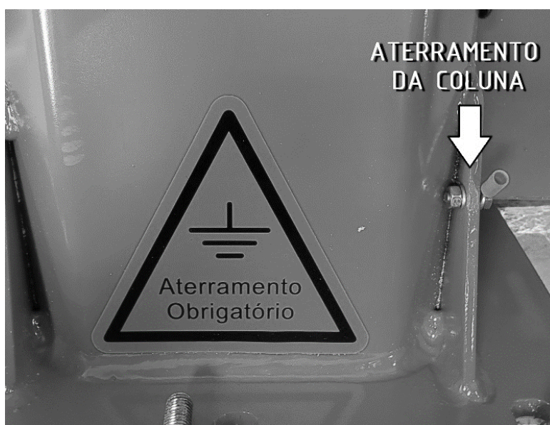
Ponto de aterramento da coluna
